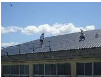
体育館屋根の雨漏り修繕
