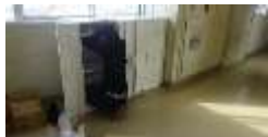
設置工事中のキャビネット (収納したら充電できる) ※廊下が広いので、じゃまになりにくいという利点
